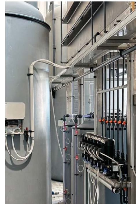
Impianto di cromatura e depurazione Chrome plating and purification plant
